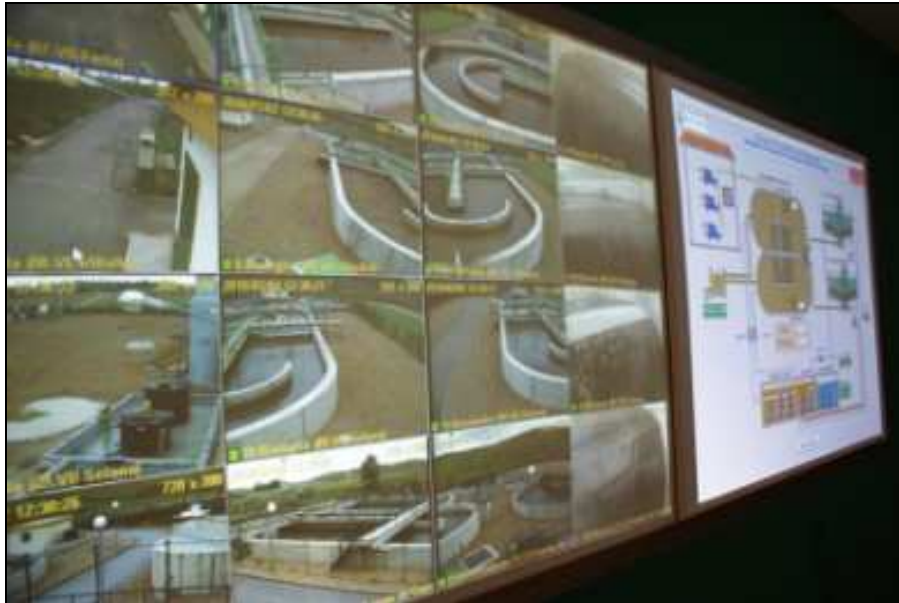
Ilustración 4. Pantallas de Control de Cámaras y sinópticos.
