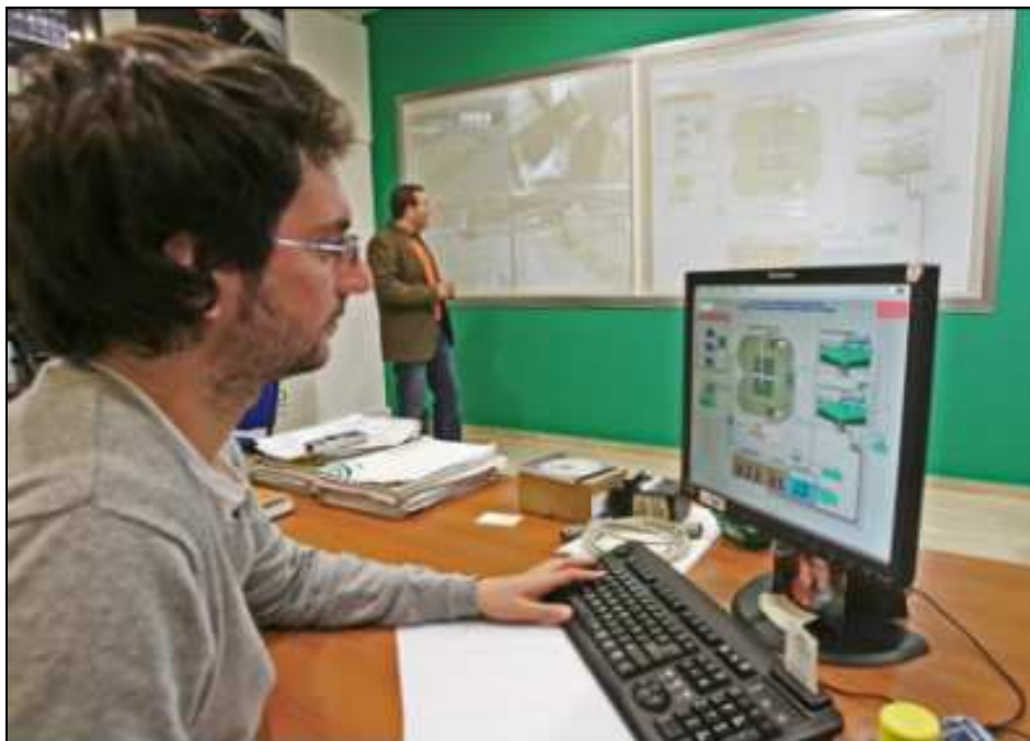
Ilustración 3. Operativo del Sistema de Telecontrol de Instalaciones de Promedio
